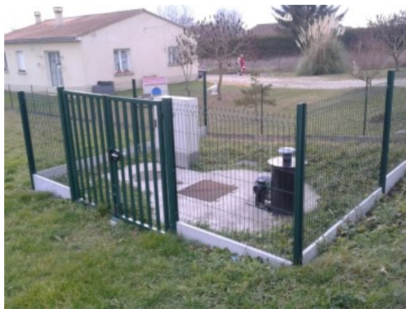
Ici le poste de relevage des Velennes
